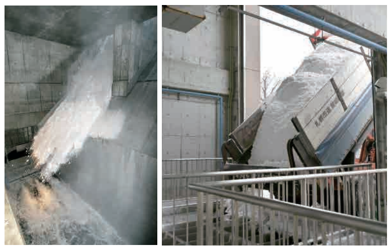
伏古川融雪管
