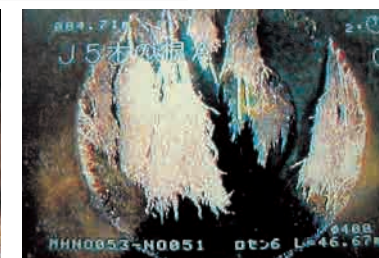
木の根の侵入
