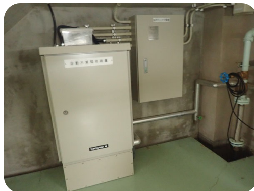
給水水質自動監視装置
