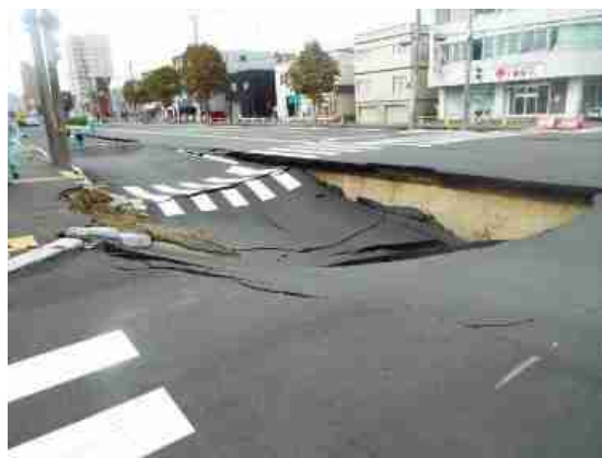
図 2-37 地震発生後の道路陥没の様子 (平成30年北海道胆振東部地震) 資料：札幌市
