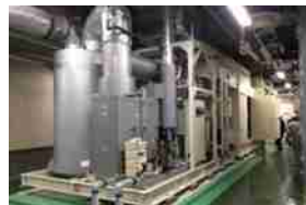
図 2-42 エネルギーセンター
