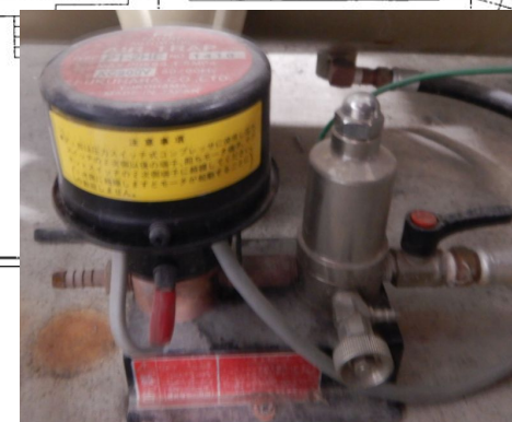
写真2 オートドレントラップ
