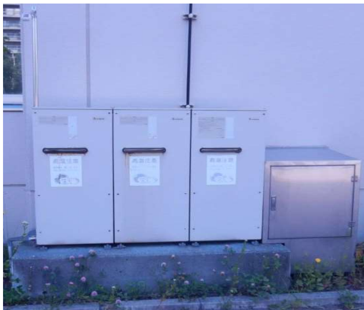
融雪設備熱源機器
