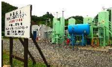
天然ガス採取プラント
