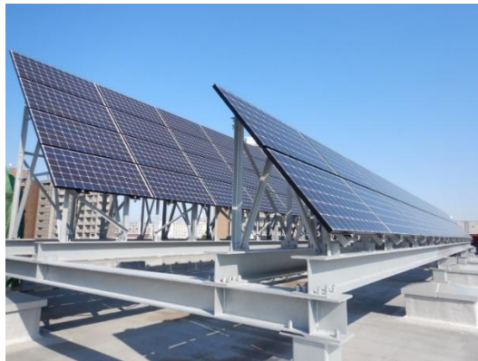
豊平庁舎の太陽光発電設備
