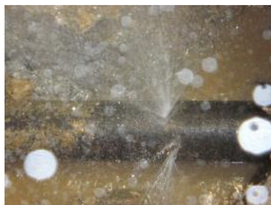
配水管からの漏水
