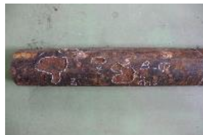
腐食が進んだ配水管（約 50 年経過）
