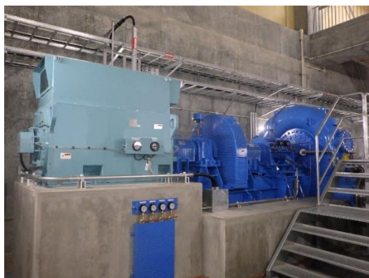
平岸配水池の水力発電設備
