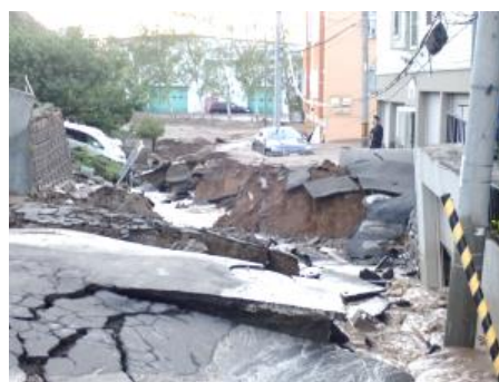
液状化による陥没
