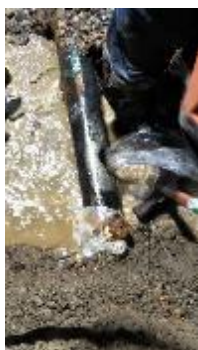
配水管からの漏水
