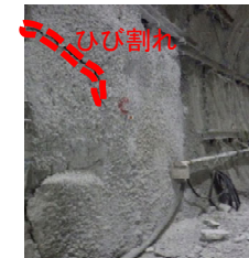
吹付けコンクリートのひび割れ
