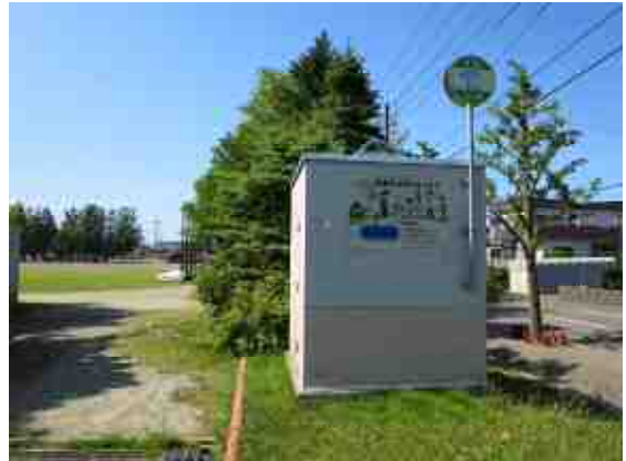
公園に設置された緊急貯水槽
